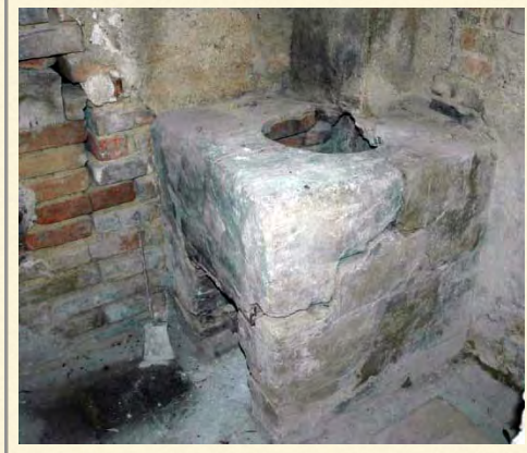
Fig. 5.27 – Fornacetta in muratura
